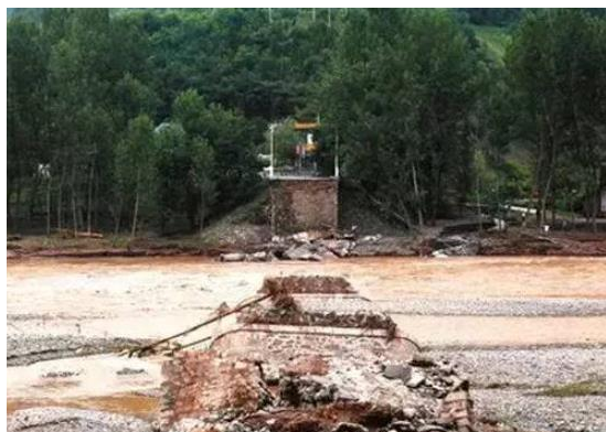
图 1.3 伊河汤营大桥垮塌事故
