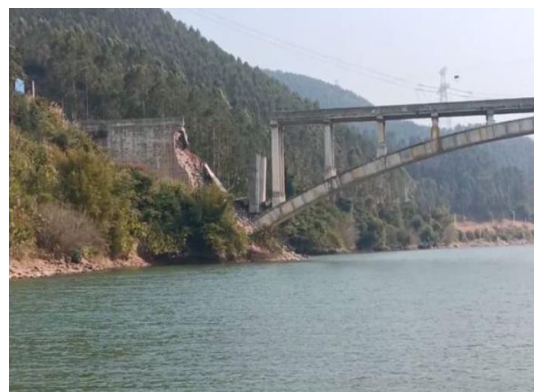
图 1.4 贺州步头大桥桥面板坍塌事故
