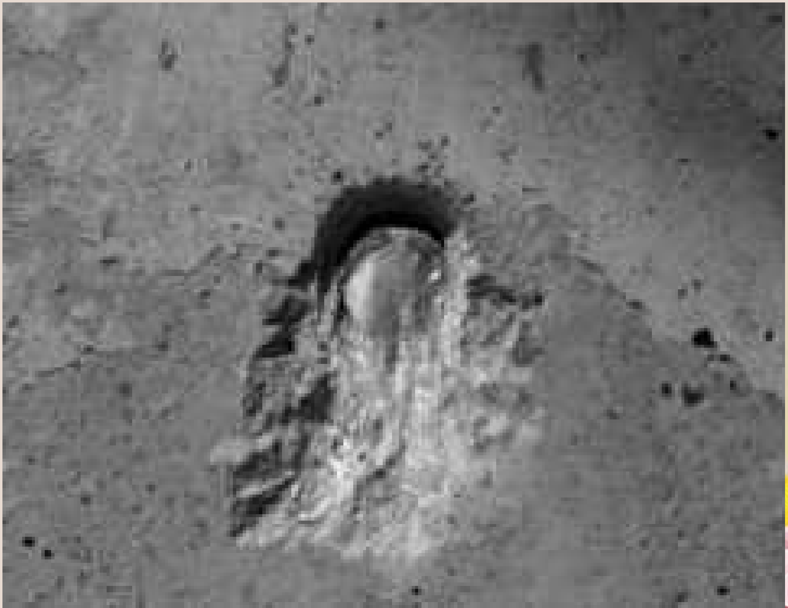
界面处受栓钉挤压混凝土的断痕
