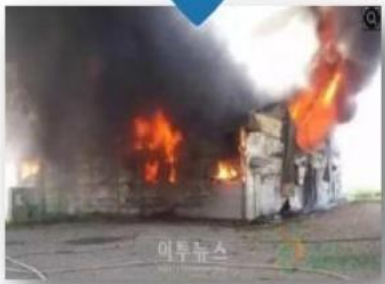
韩国灵岩风力发电厂 ESS 设备
