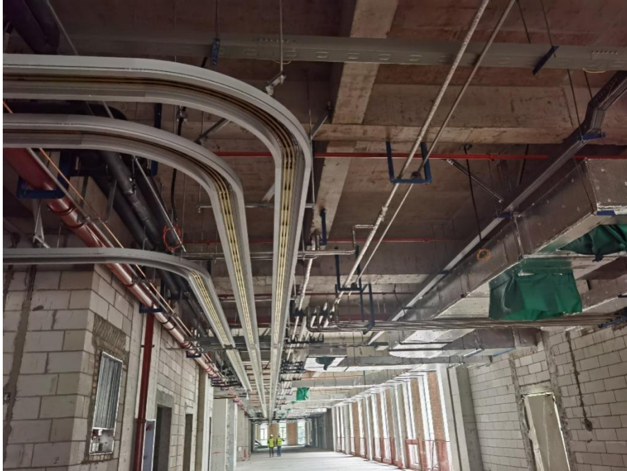
轨道与风管不能上下层平行安装
