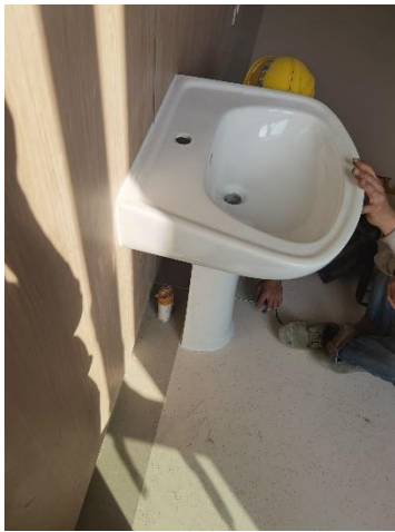
诊室等房间采用 5cm 抗菌装饰板，洗手盆的排水管与给水软管不能有效隐蔽，且给水点接头位置全部增加内丝接头等管件
