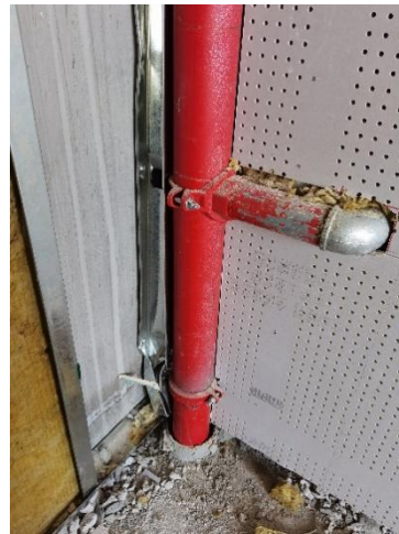
预留预埋施工时，精装修图纸未出，导致预埋的套管与装饰面冲突，管道半明半暗
