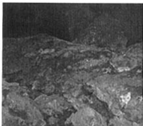
(a) 顶板脱层冒落
