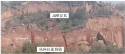
图 10 陡坡坍塌现象
