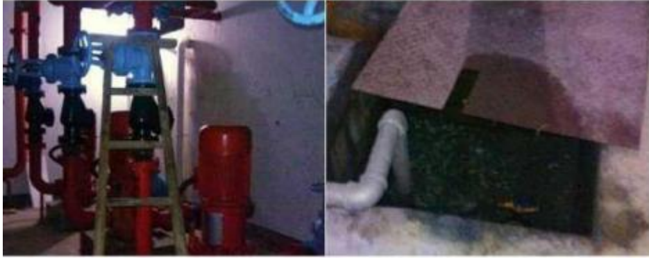
地下消防水箱和水泵房自动排水坑
