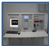
消防设施监管
