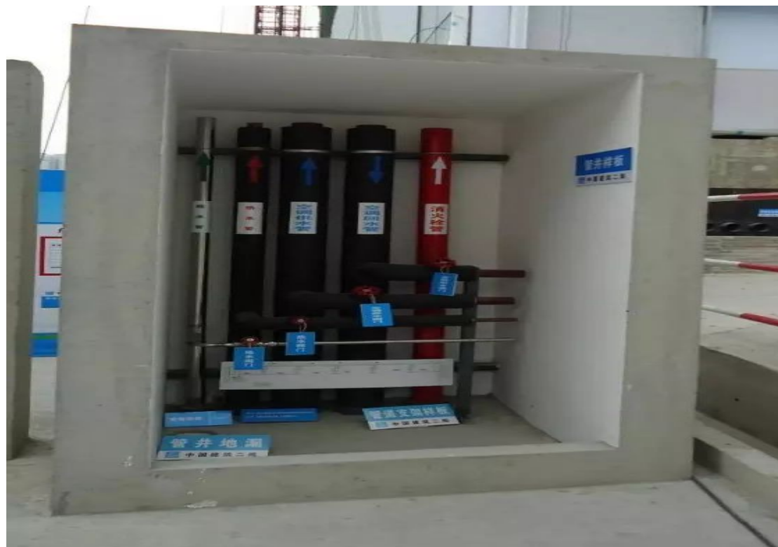
7 机电综合管线样板
