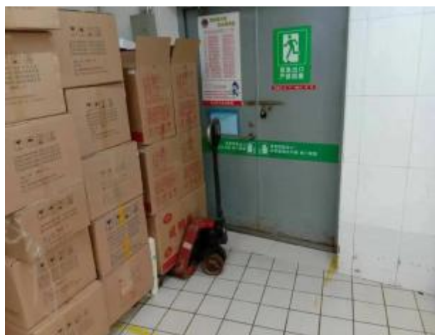
安全出口处不得堆放杂物(×)
