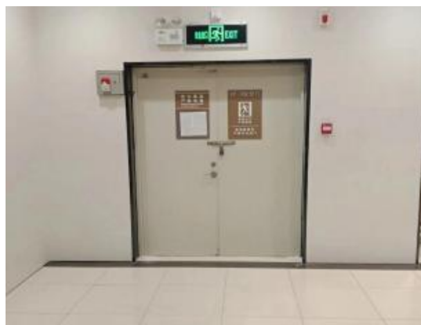
安全出口处应保持畅通(√)
