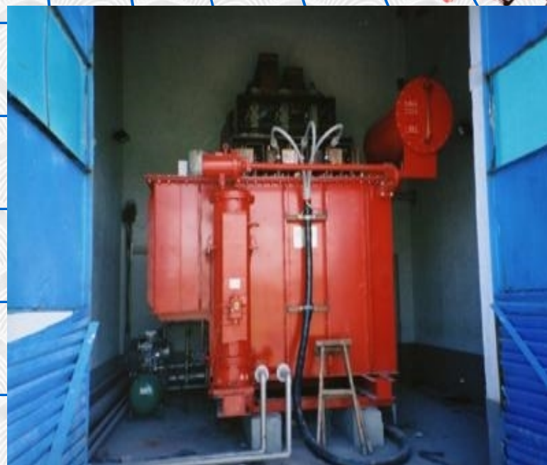
静电除尘器升压变压器
