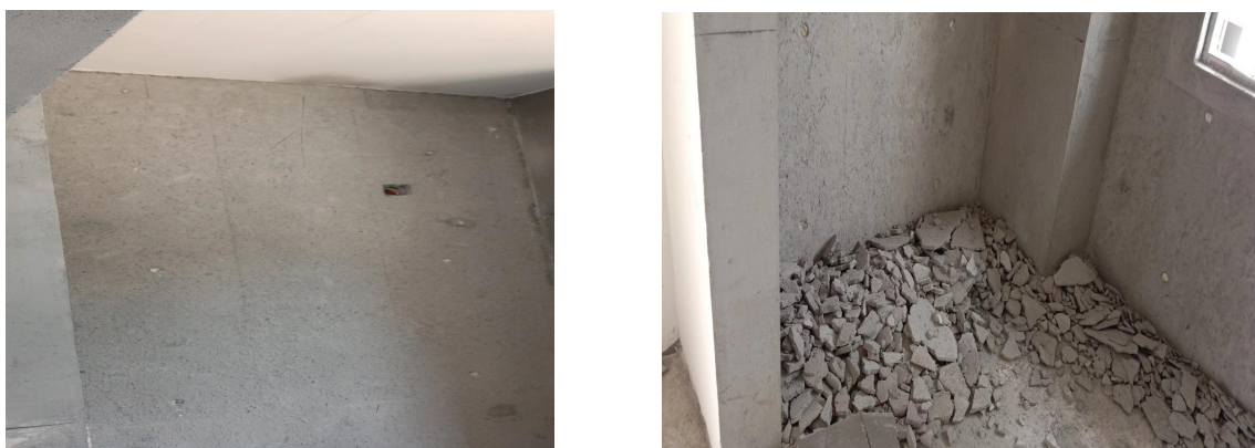
图 3-1 现场空鼓现状
