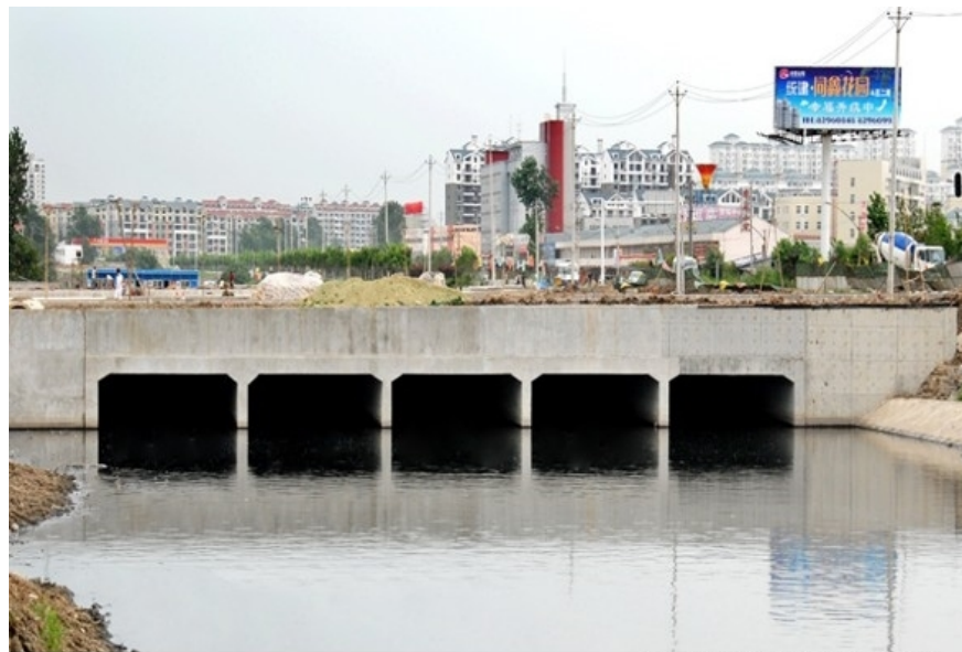
汉口后湖地区大型排水箱涵
