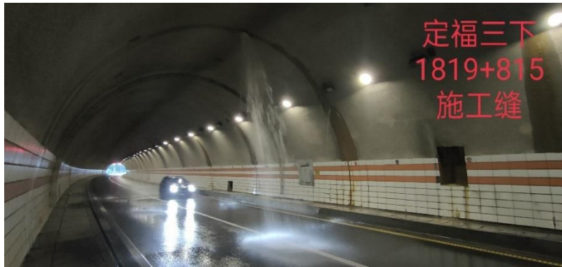
图 2-3 河都路下行 K1819+815 施工缝喷水
