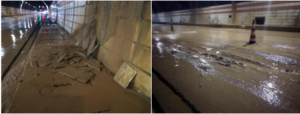
图 2-2 河都路高岭 2 号隧道运营期间的突泥
