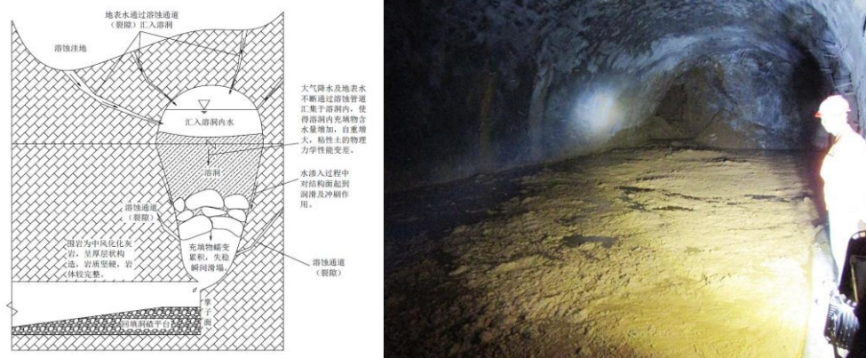
图 2-1 河百高速平坎隧道“11.19”突泥事故
