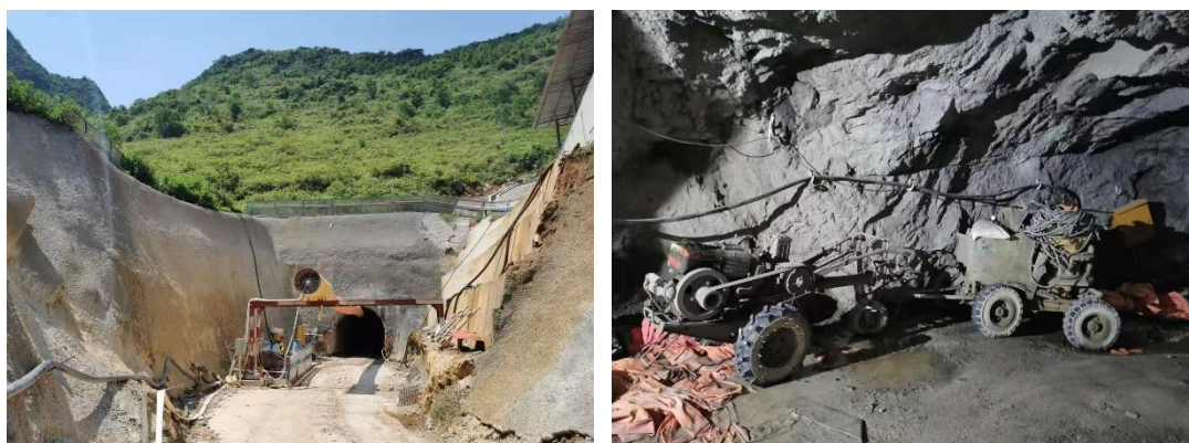
图 3-5 编写工作组前往广西柳州经合山至南宁高速公路俭常连接线泄水洞施工现场
