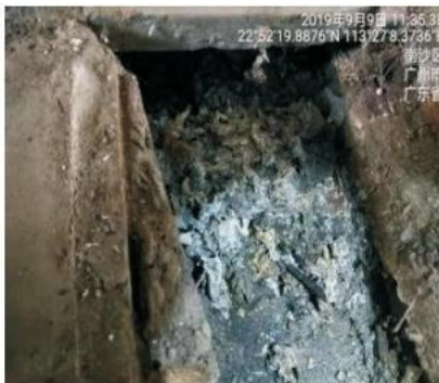
废渣等废物流入雨水井
