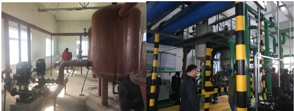
照 7 山东省陵县砂岩热储地热尾水回灌照 8 山东省东营市砂岩热储地热尾水回灌
