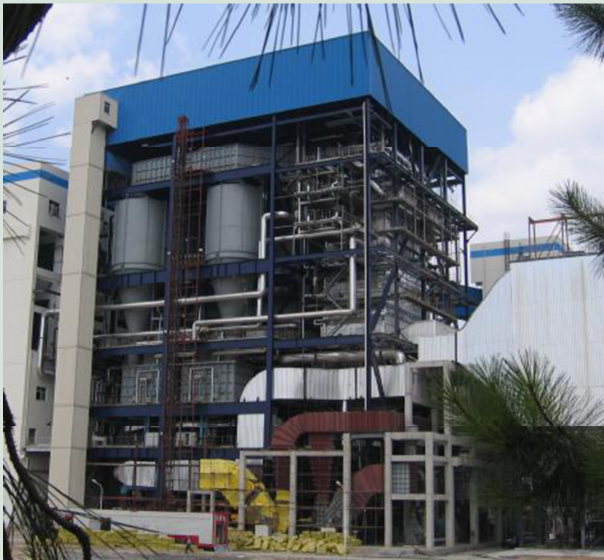
300MW循环流化床锅炉
