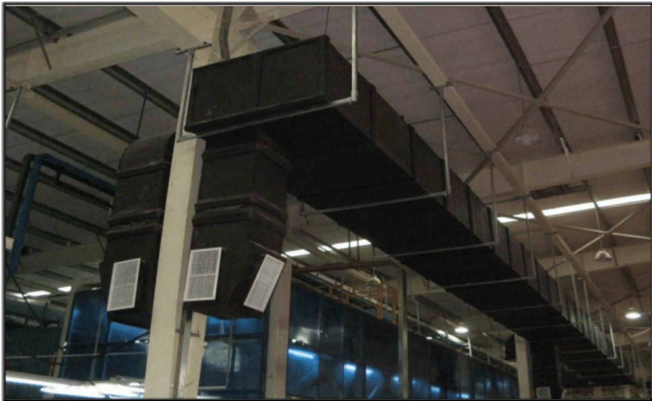
风管安装实例图
