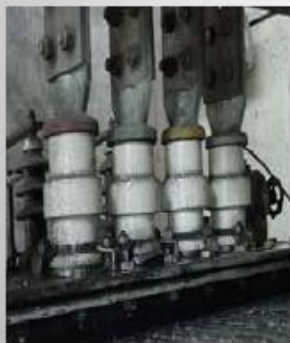
变压器绝缘油渗漏和套管脏污
