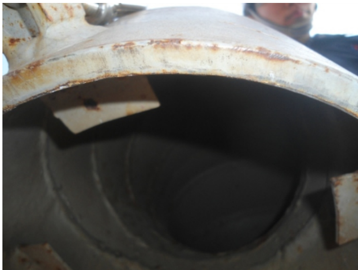
风管上滤网未安装
