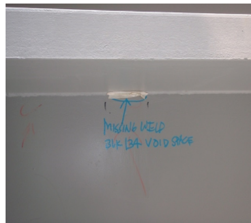
分段漏焊现象，导致油漆需要再次修补
