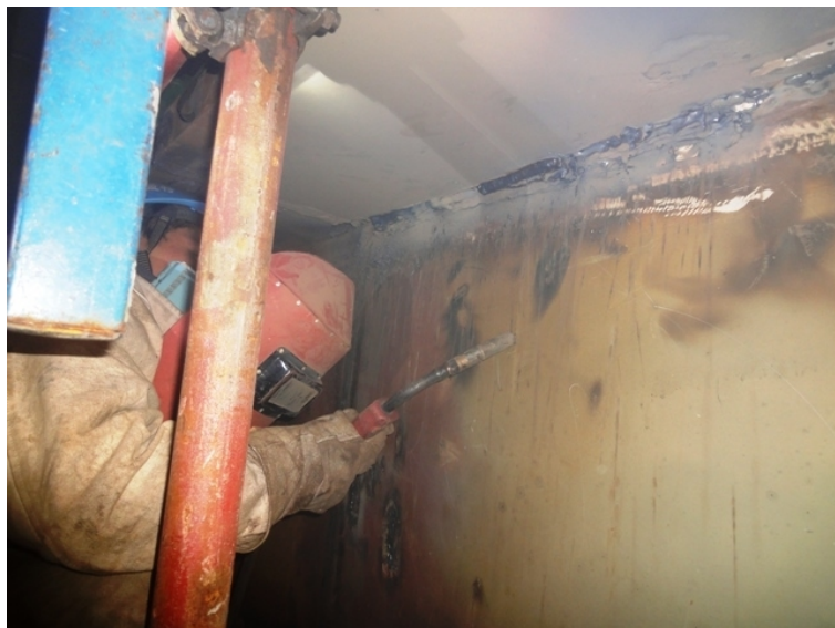
超厚板烧焊未预热，导致全部刨掉重烧
