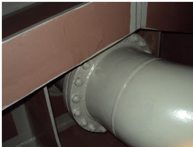
螺栓不方便拆卸，导致后续给船东提供气动扳手，增加单船本钱
