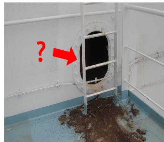
通到机舱棚的人孔无法使用
