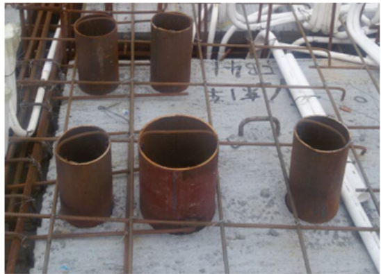
管道井内给水套管续留
