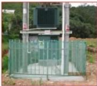
项目部变压器
