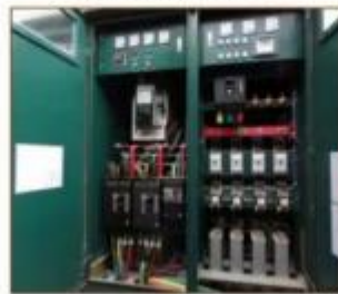
总配电箱(一级)
