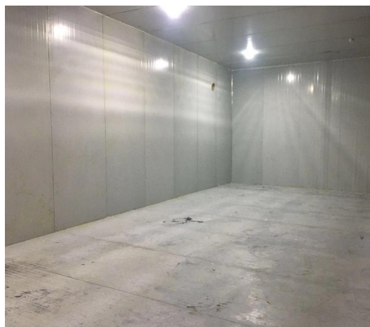
图 4-13 医废贮存间防渗地面
