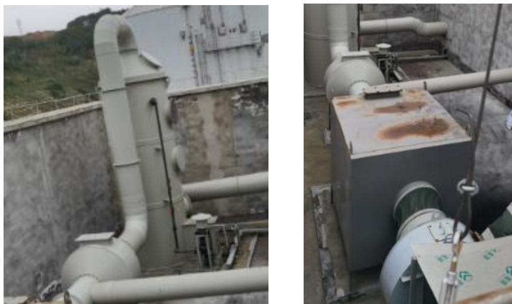
图 4-4 废气治理设施
