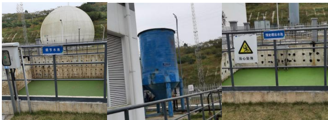
图4-2 废水预处理站
