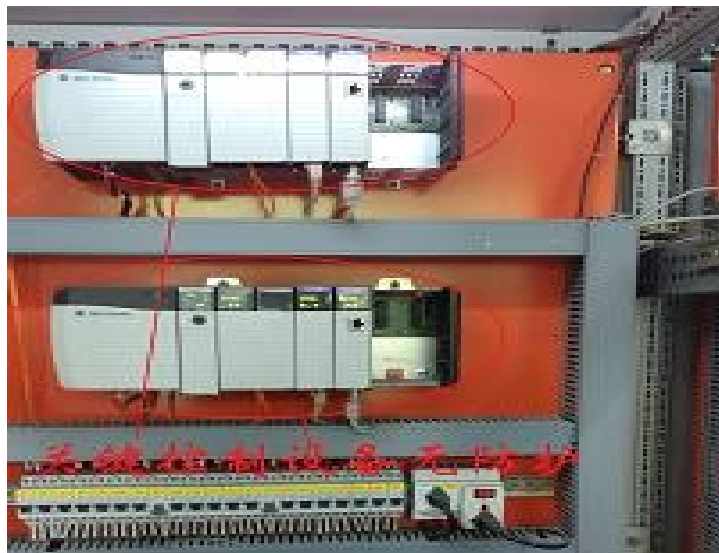
现场控制设备无防护
