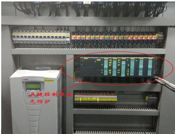
现场控制设备无防护
